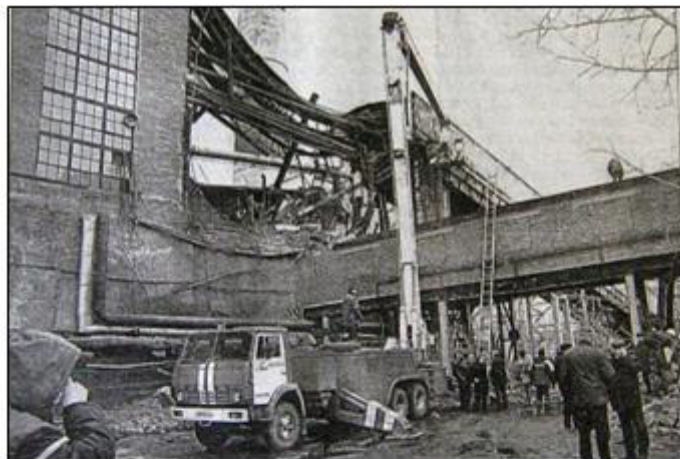
Авария на ТЭЦ-2 23 марта 2006 г. Обрушился угольный конвейер. Многотонная металлическая конструкция раздавила хозяйственную пристройку. Погиб один рабочий, двое ранены. На снимке - место обрушения, идет разбор завалов. Фото А.Каспришина.
