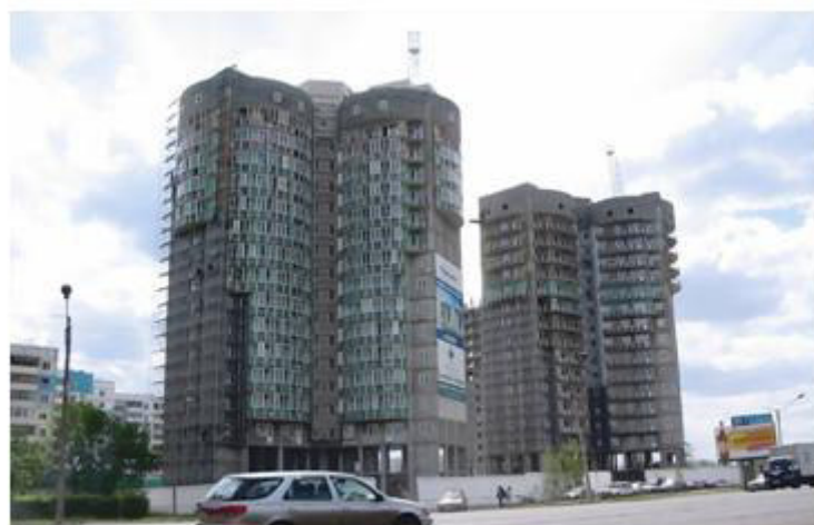
Строящиеся 16-и этажные жилые дома по Павловскому тракту, 243 и 247. Строительство закончено в 2008 г. Фото автора, 2007 г.
