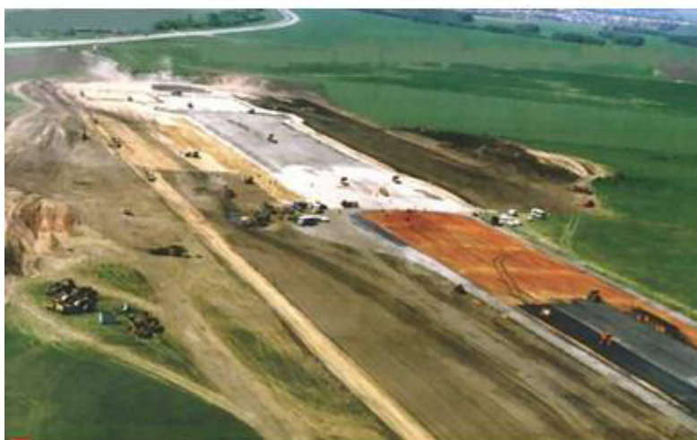
Реконструкция взлетно-посадочной полосы Барнаульского аэропорта. Фото 1998 г. Из фондов музея «Дороги Алтай»
